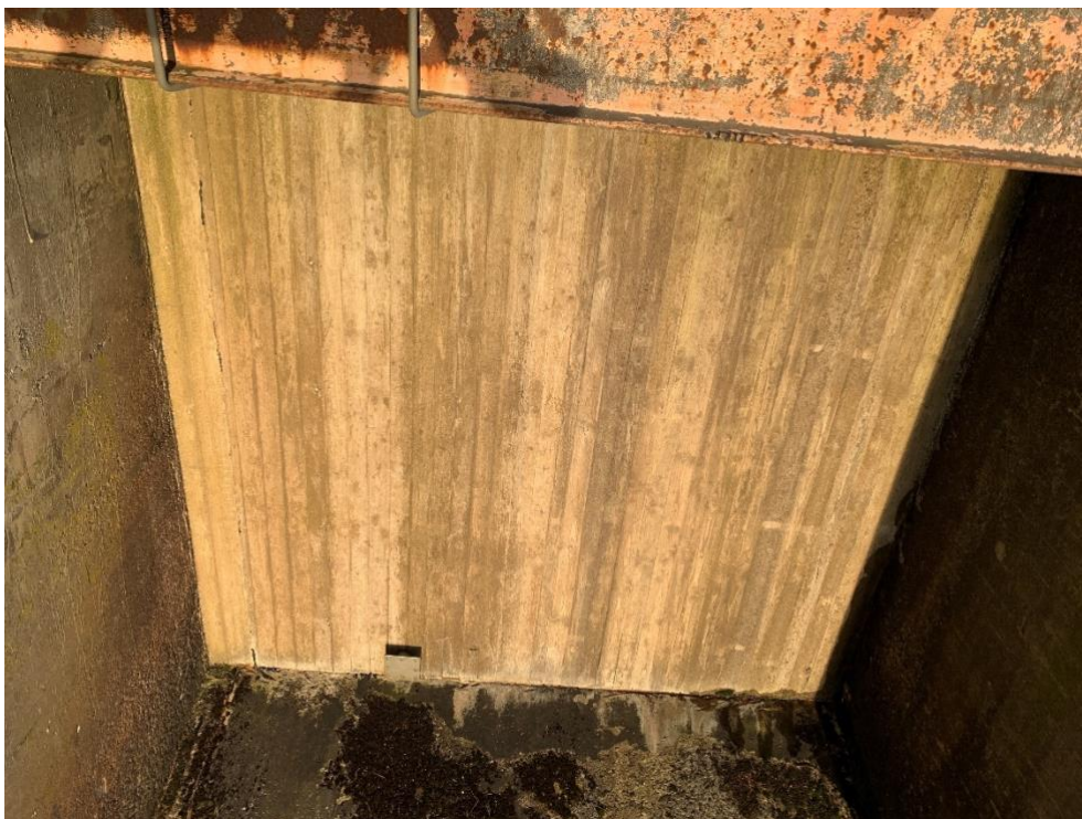
Figur 5 Nedströmsvy av isutskovet. Till höger i bilden slaggbetong och till vänster anläggningsbetong.
